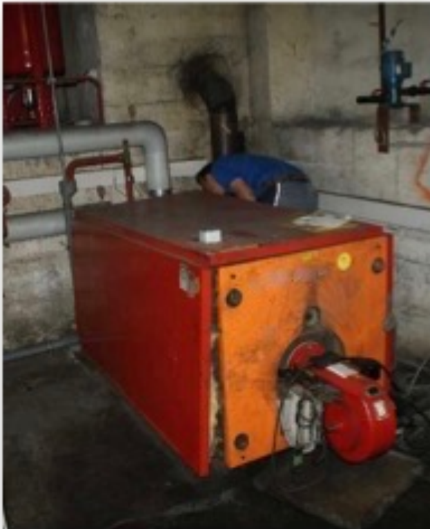
Quelle: Kurs der Kantone Luzern/Aargau „Heizungs-Check“
